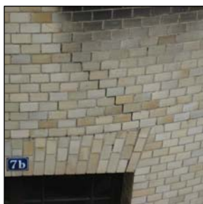
Spricka i fasad
