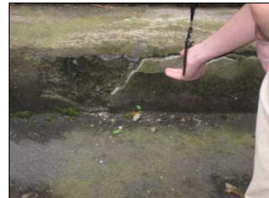
Lösa betongsjok på murens betongsockel
